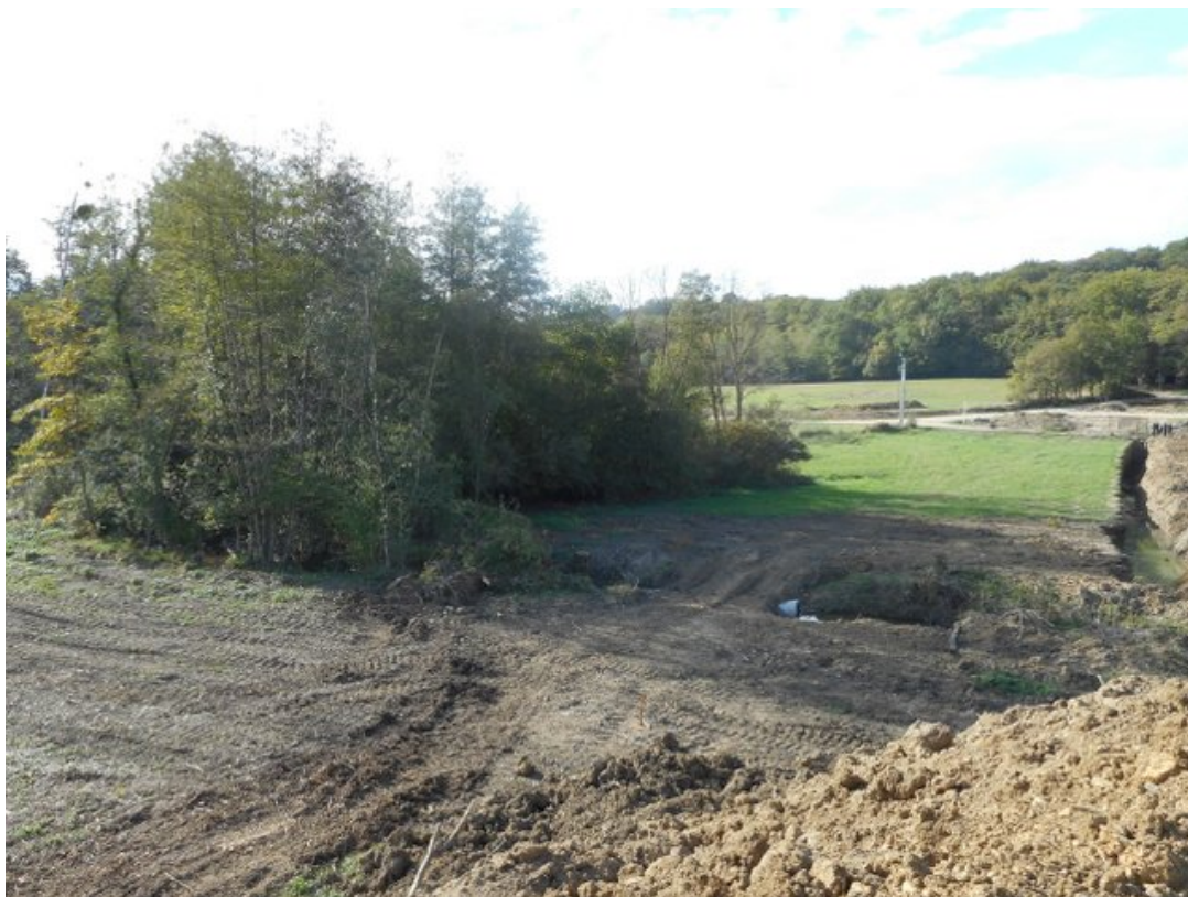
Photo 1 le 25/10/2014 à 15 :41 vue sur la partie amont de la zone humide non détruite, observation du passage busé, du sol tassé , du fossé de drainage, du pied de remblais
