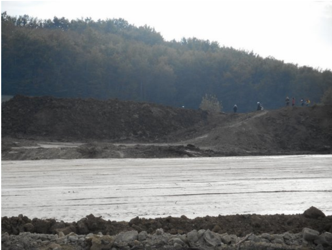
Photo 9 le 25/10/2014 16:26 vue éloignée vers l'aval rive gauche, au premier plan espace terrassé (fondation de la digue ?), puis remblais au second plan dont une partie est probablement située sur la zone humide qu'il fallait préserver
